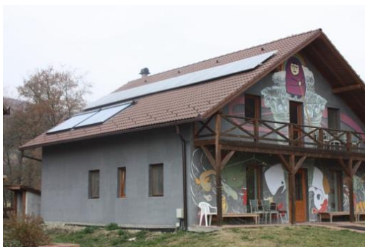
Foto: Arcus Valea Iriszcamp, zonnepanelen op het logeerhuis.
